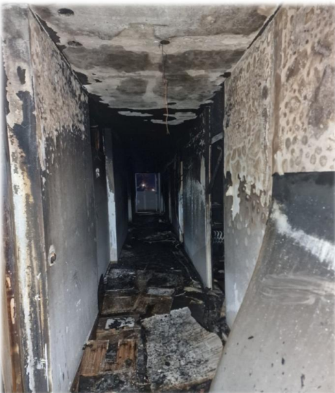
Kuva 13 Palo aiheutti mittavat vahingot
