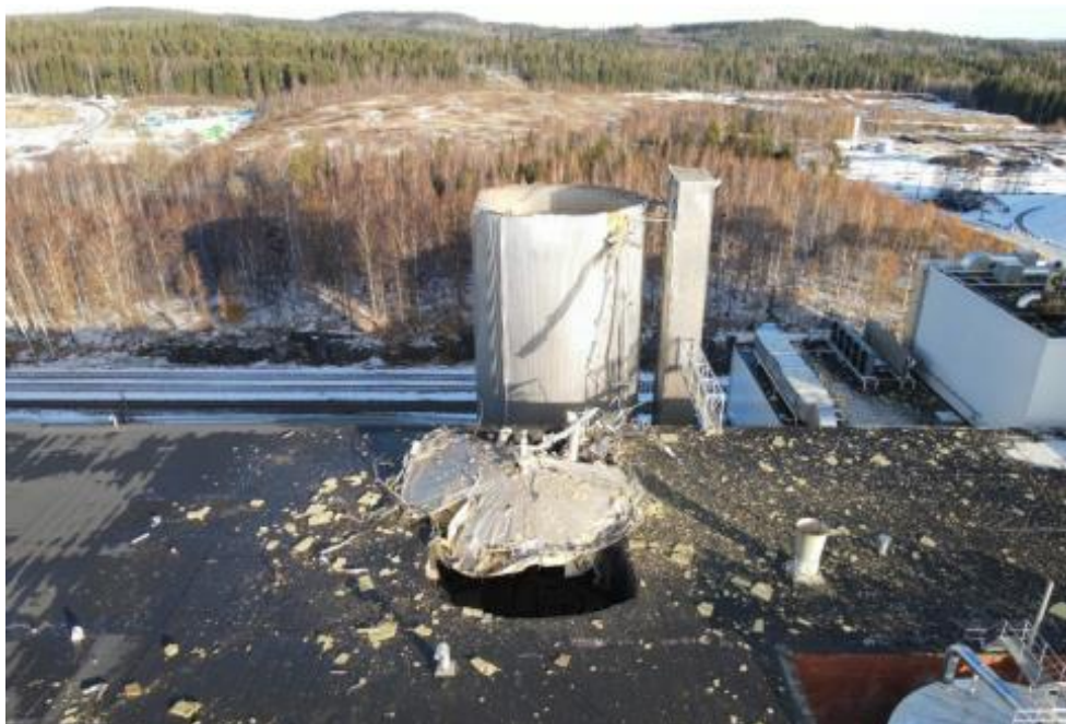
Kuva 7 Räjähdyksen seurauksena massatornin katto irtosi ja lensi viereisen rakennuksen katolle.
